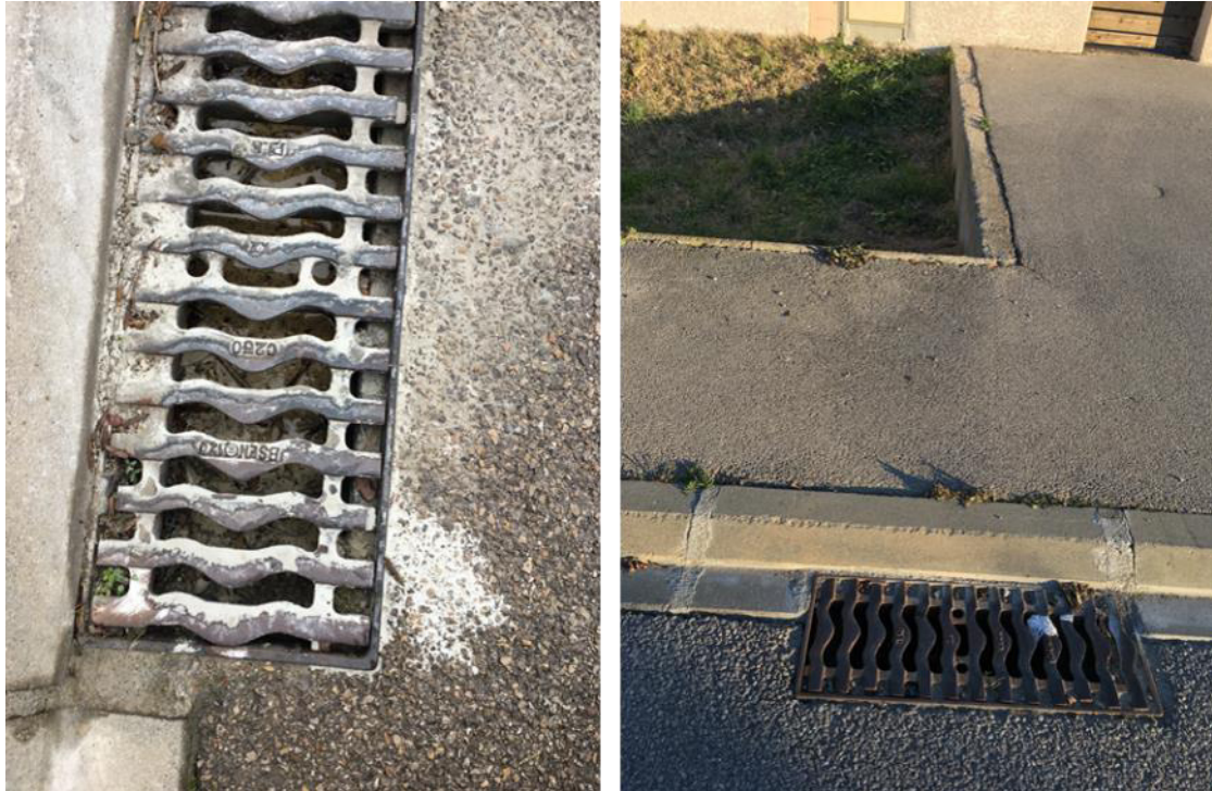
Figure 22 : Photos de grilles non connectées aux noues
