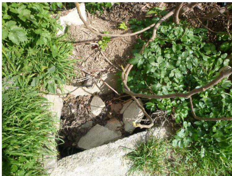
Figure 36 : Vue de l'obstruction de l'écoulement au droit de l'exutoire 09
