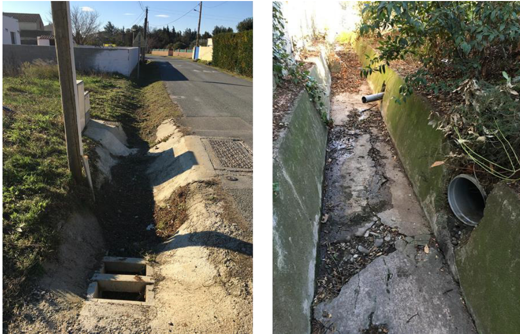
Figure 28 : Sur-profondeur du fossé (à gauche) et canalisations se rejetant dans le fossé bétonné affluent au ruisseau de la Balme (à droite)
