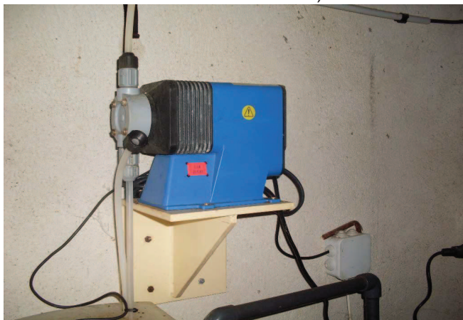
Traitement / pompe doseuse de chlore (solution préparée à base d'eau adoucie)
