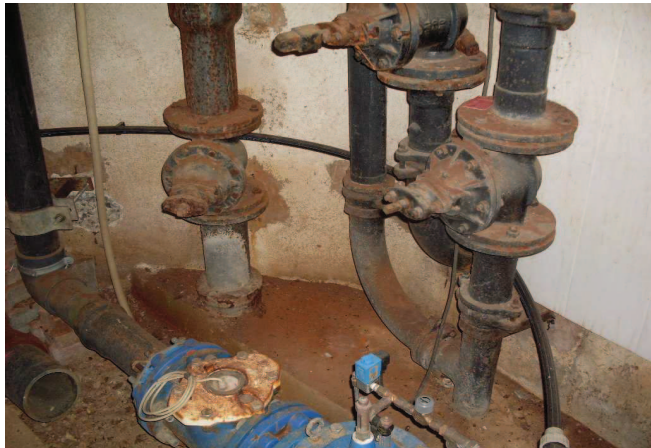
Chambre des vannes
